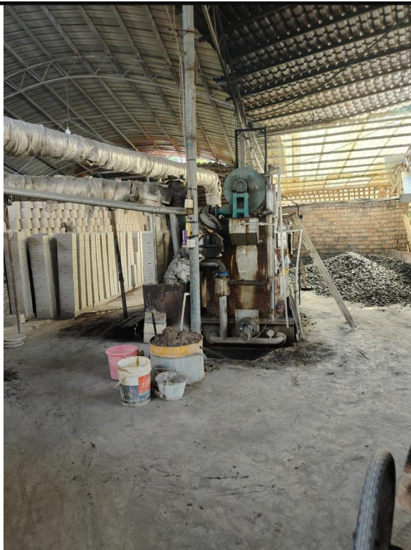
燃煤供热设备
