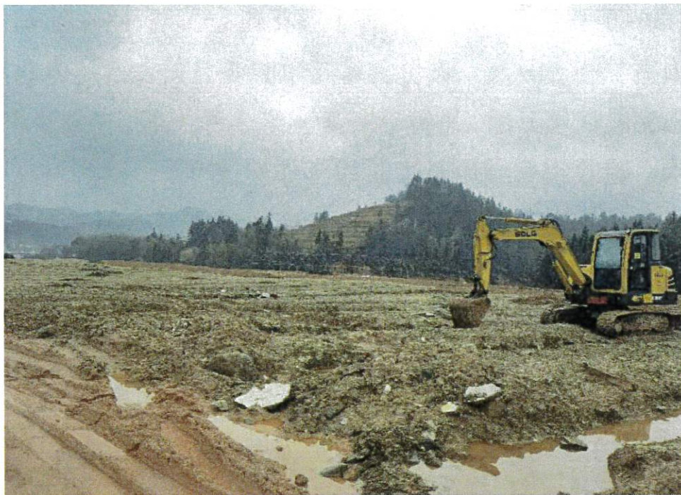
炎陵县康乐大道现场修复前照片 1（近景）
