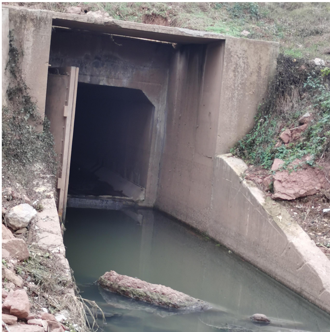
整改后的鹅颈洲排渍站入河排口
