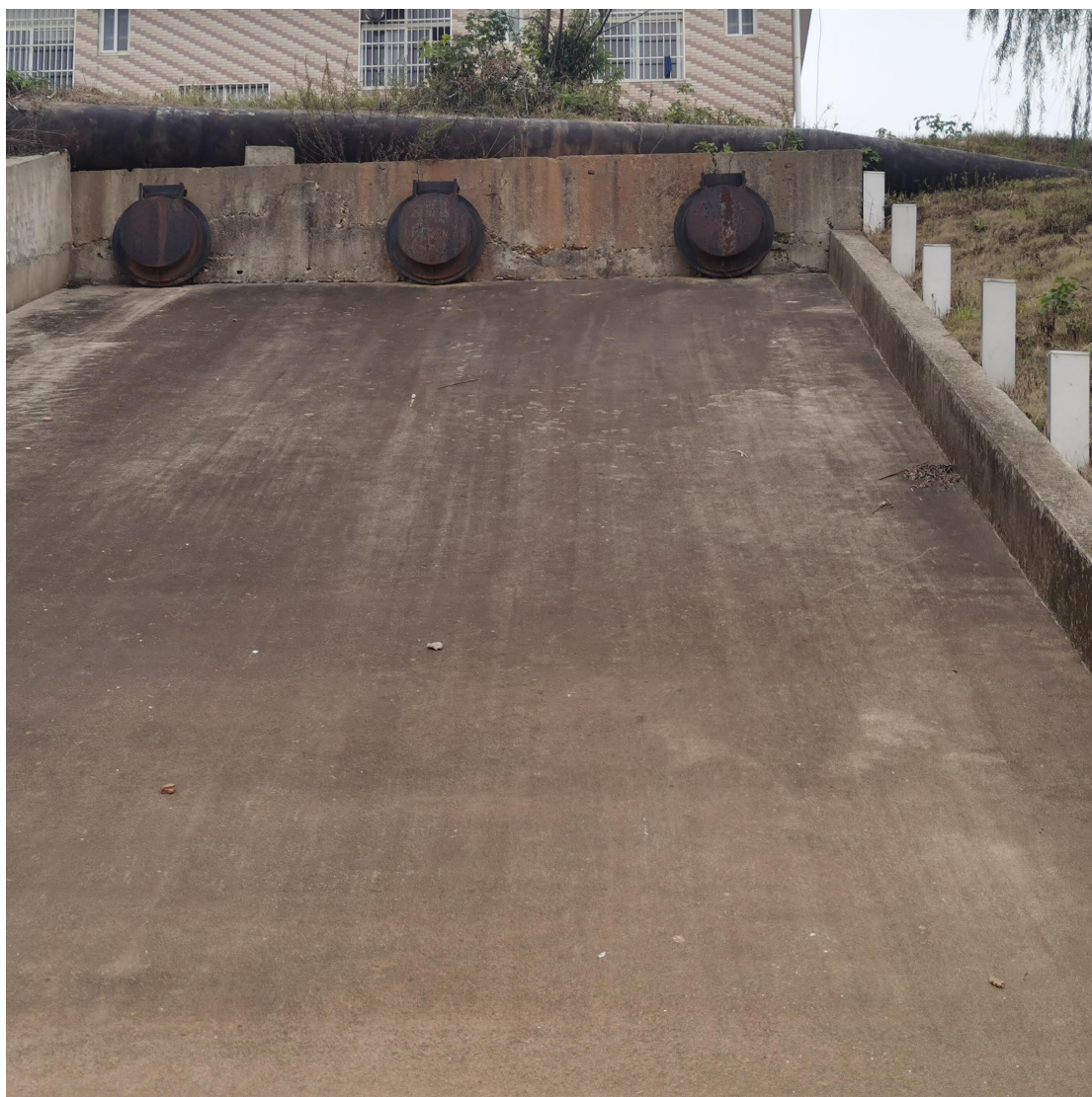
整改后的鹅颈洲排渍站入河排口
