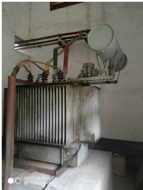
水电站变压器
