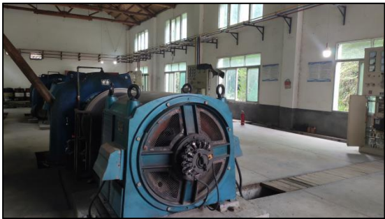
水电站厂房内部
