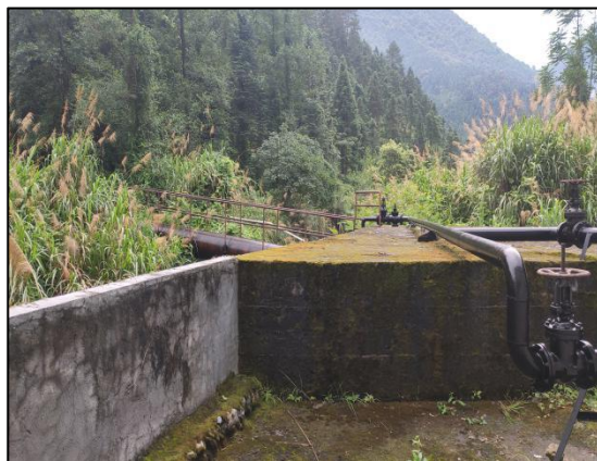
电站压力管道
