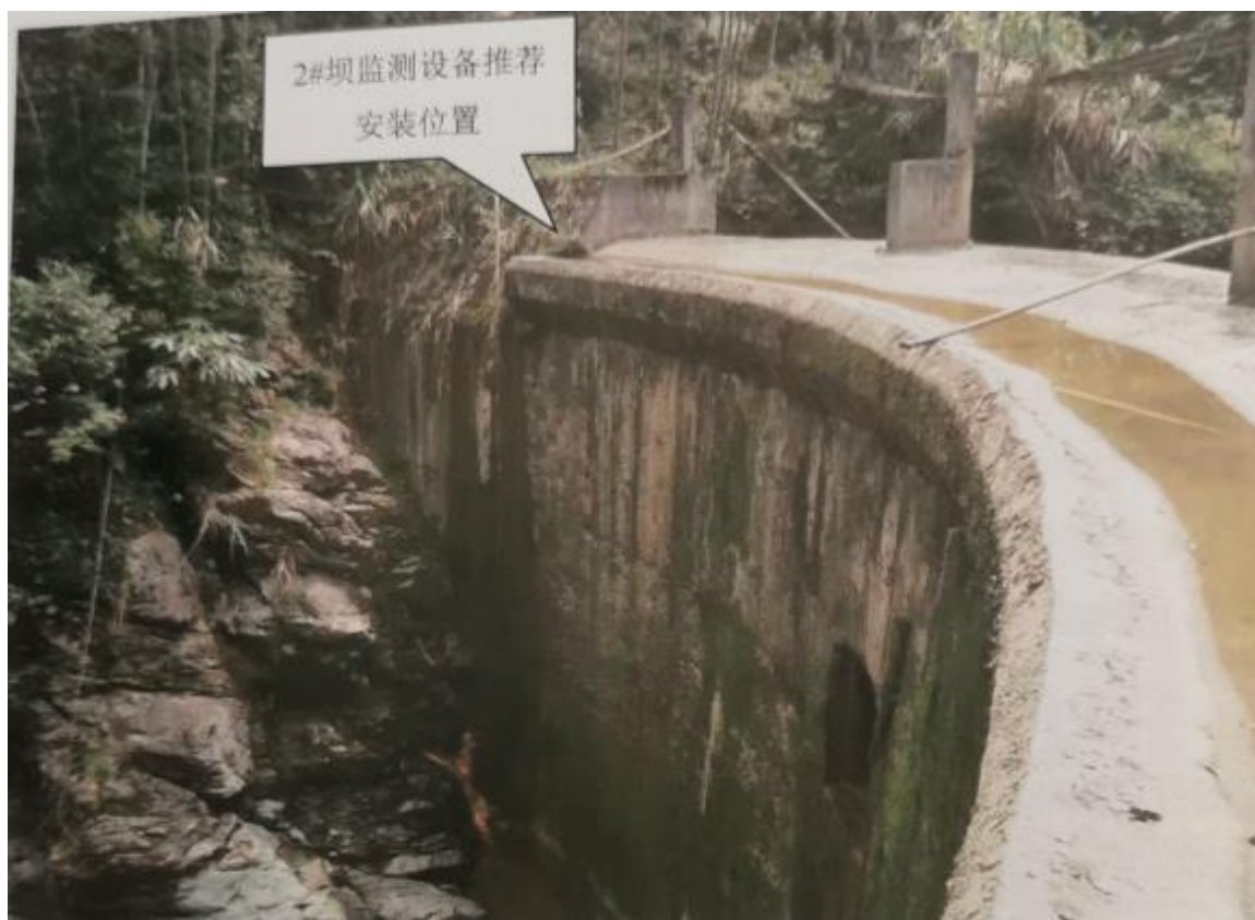
图 5.1-2 双奎水电站监测设备安装位置图
